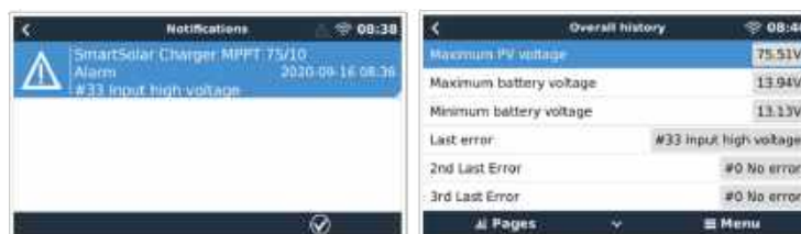
Appareil GX affichant une notification d'alarme et des erreurs historiques.
